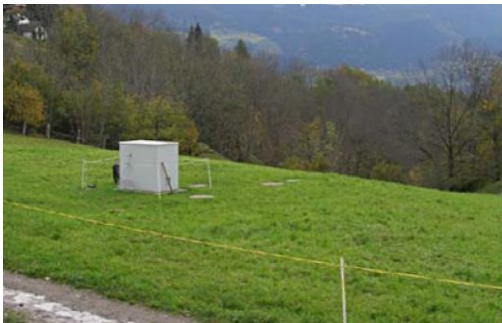
Figura 4: Impianto in funzione, armadio con quadro comando
